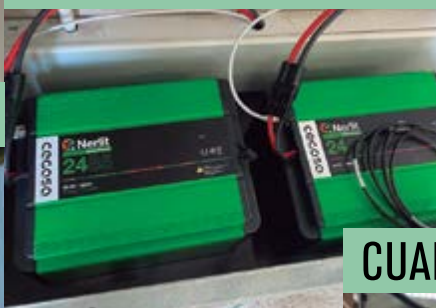
BATERÍAS DE LITIO
